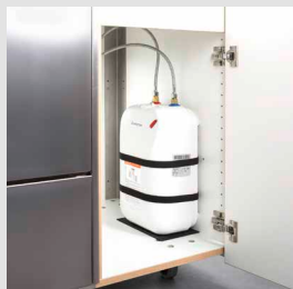
Klettbänder und Anti-Rutsch- matte zur Sicherung von Warmwasserspeicher
